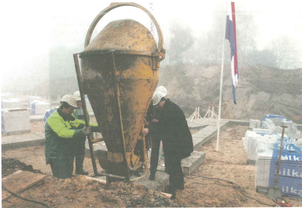
Wethouder Robert Visser, Frank van de Weijer (Visade) en Jef Havermans (aannemer Dura Vermeer Bouw) storten beton voor de eerste tien huizen aan de Brink in Sonniuspark (foto Inge van Rooij)
